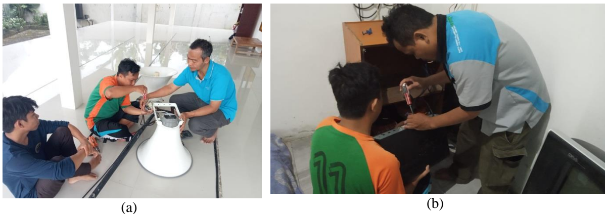
Gambar 4 Proses penyesuaian impedansi, beban sound sistem dan instalasi (a) Praktek penyeragaman impedansi speaker outdoor dan (b) Pratek pengelompokan beban untuk ke-3 amplifier.
